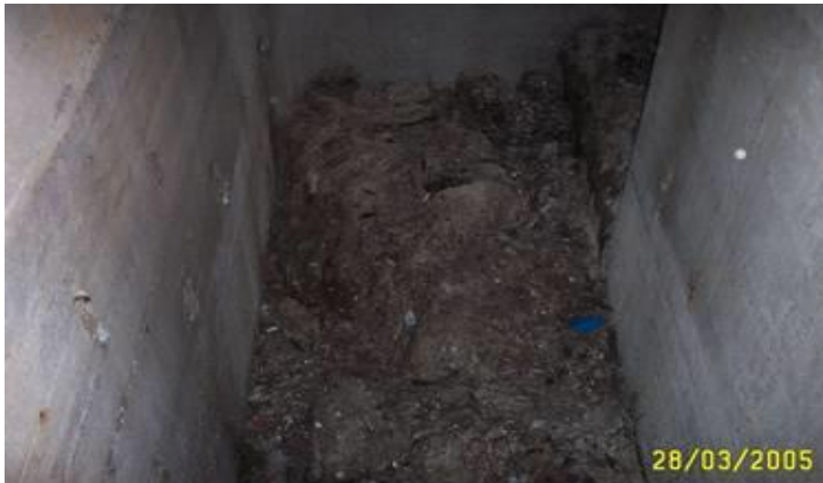
Figura 1 Sedimentos en conducto existente.
