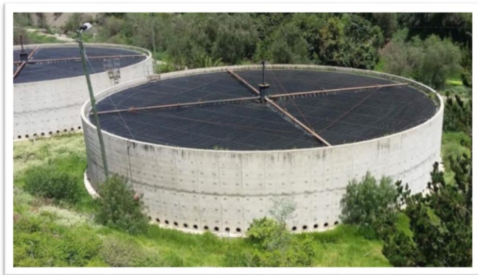
Figura 9 - Imagen representativa – Lechos Percoladores
